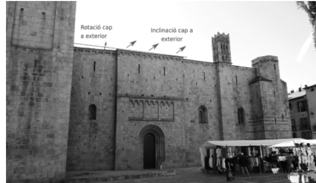
Figura 9. Deformacions dels laterals de la nau, visibles a l'exterior
